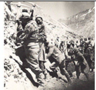
Obreros de la construcción de carreteras cerca de Kullu, Himachal Pradesh, India, a principios de la década de 1960.
